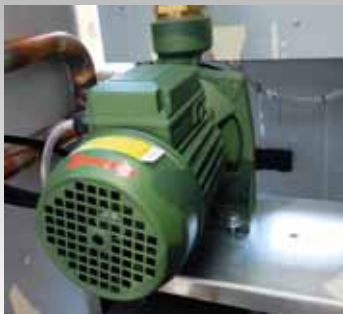
Pompa di circolazione - Circulating pump
